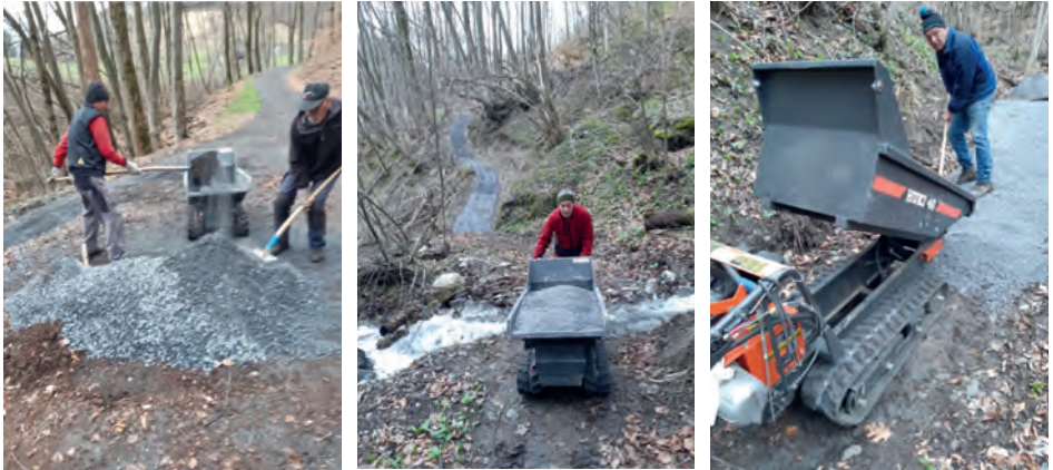
Arbeiten für die Zufahrten zum Bauplatz für den Materialtransport mit dem Hucki.
